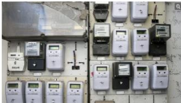
La imatge d'uns comptadors elèctrics / CRISTINA CALDERER
